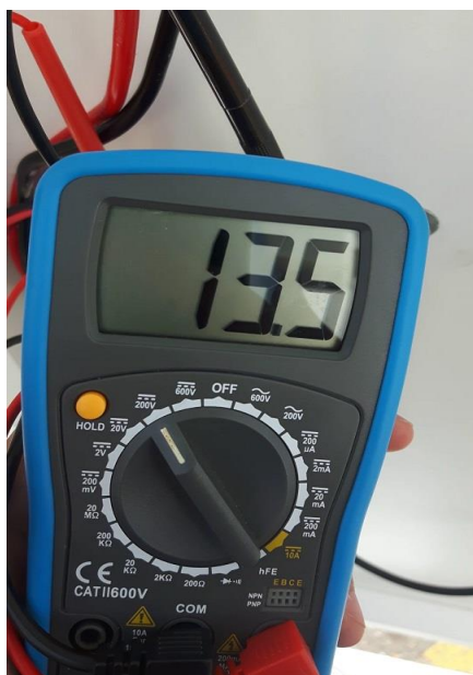
Figura 7 – Valor da tensão na entrada do inversor.
