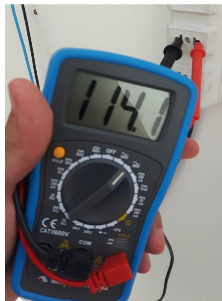
Figura 8 – Valor da tensão na saída do inversor.
